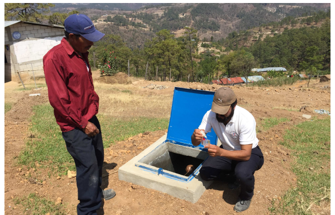
Las Comisiones de Agua y Saneamiento facilitan el acceso a los sistemas de agua para su monitoreo de forma periódica.
